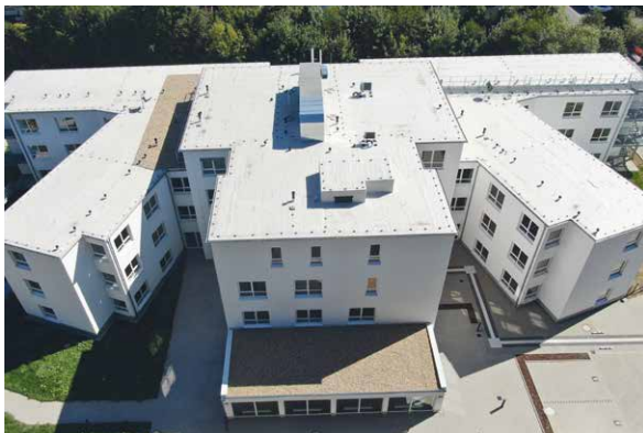
Blick von oben: Das neue Friederike-Fliedner-Haus in Bad Berleburg. [Foto: Berge-Bau GmbH]
